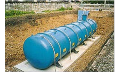
【耐震性貯水槽】
