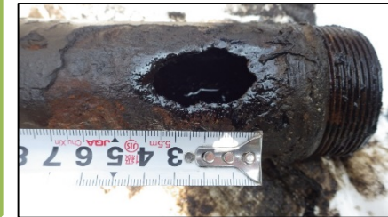
【腐食した埋設配管】
